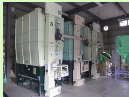
（乾燥調整施設（粃搬送ライン））
